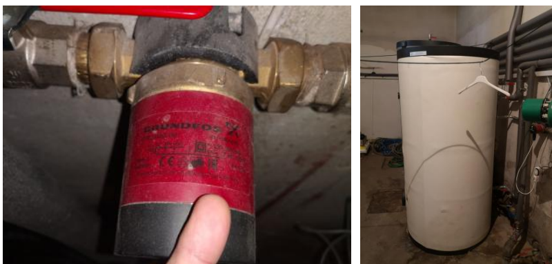
Obrázok 12. Vybavenie technickej miestnosti – príprava TV
