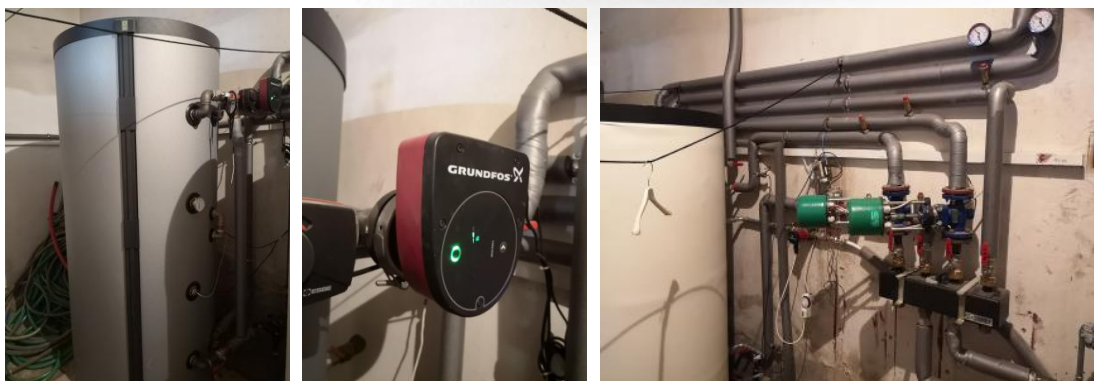
Obrázok 10. Vybavenie technickej miestnosti – príprava ÚK
